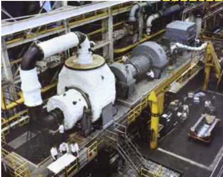
Turbine et alternateur
