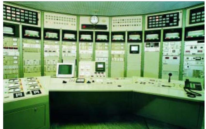
Salle de contrôle
